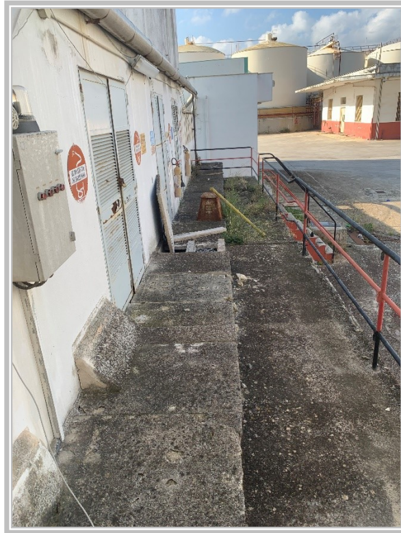
Foto n. 9 : Lotto 6 – Cabina ENEL Trasformatori
