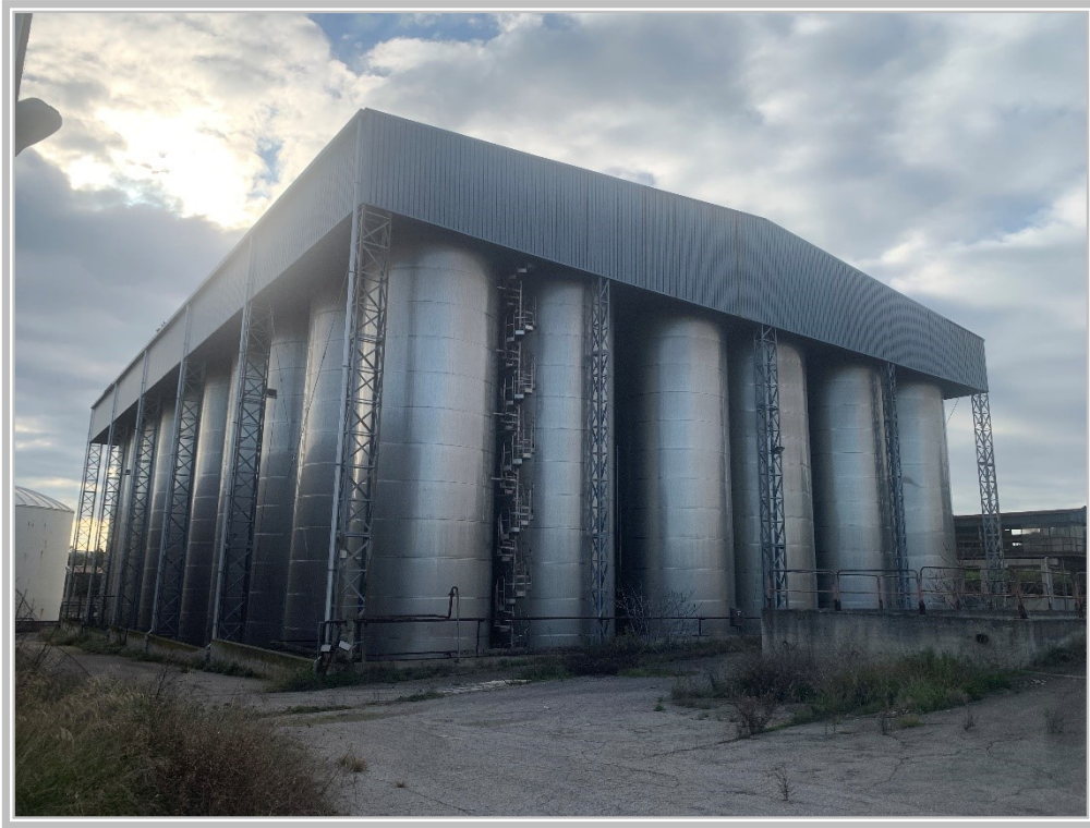
Foto n. 19 : Parco serbatoi coperti
