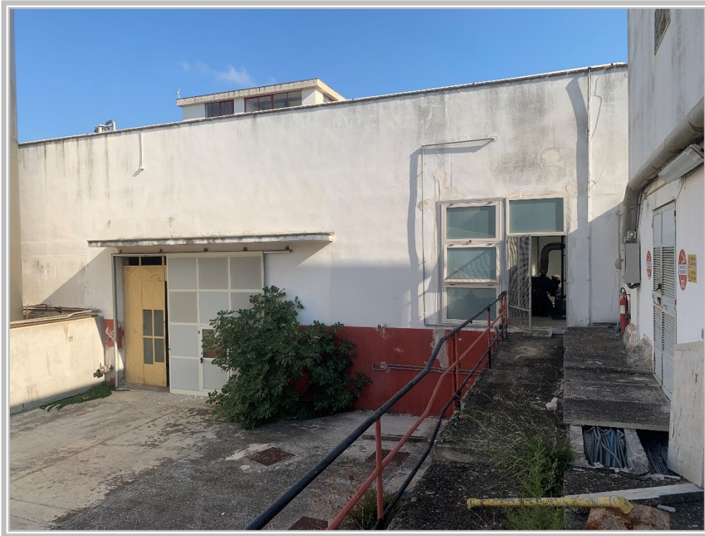
Foto n. 18 : Lotto 15 – Quadri elettrici gruppo elettrogeno
